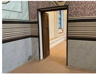
Türen zwischen den Baderäumen
