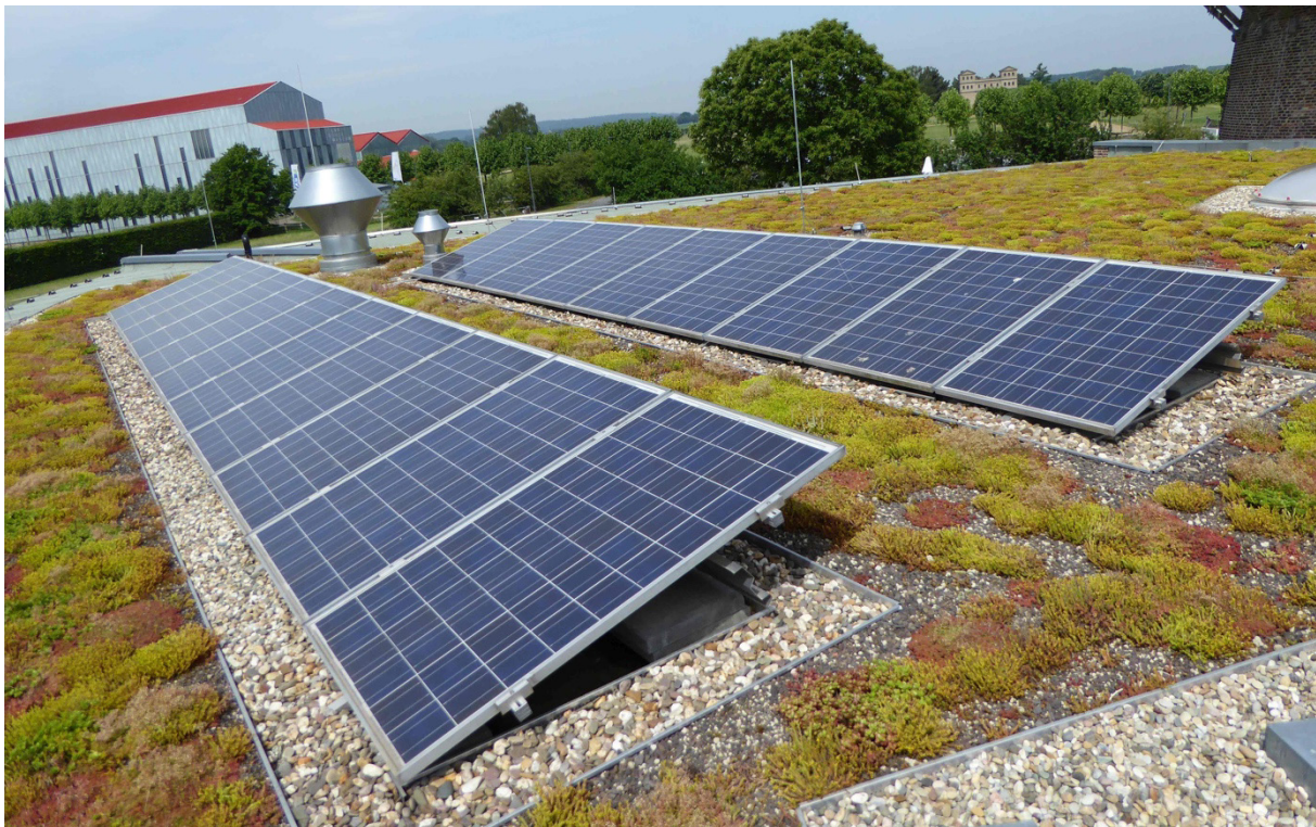
Abb. 4: PV-Anlage auf dem Dach der „Kaffeemühle“ (Foto A. Bartmann, LVR)
