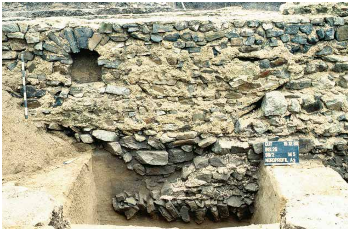
Abb. 116 Schnitt 98/2, Mauerbefund M 1 / M 1,2, Anschluss der Mauer M 1,2 an das abgetreppte Mauerende M 1, von Süden.
