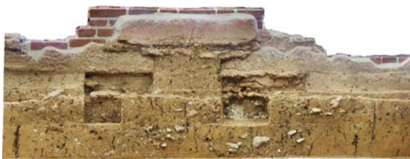
Abb. 30 Xanten, Colonia Ulpia Traiana. Insula 13. Gallorömischer Umgangstempel. Schnitt 2017/02. Mehrlagige Wandputzfragmente am Fuß der Außenseite der südöstlichen Umgangsmauer. Im Hintergrund moderne Sicherung.
