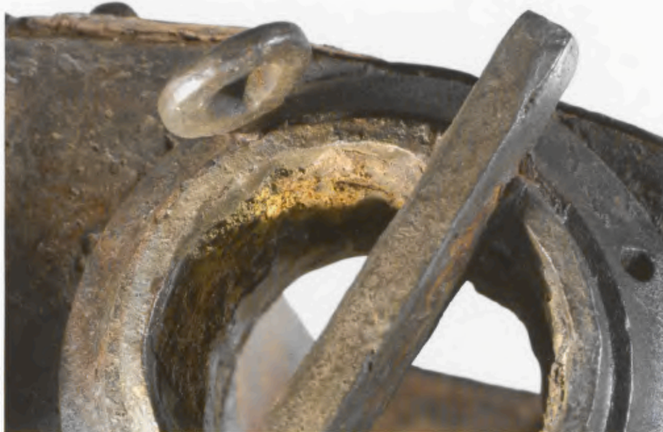
98 Spannbuchse B, während der Restaurierung im Inneren belassene Korrosionsschicht.
