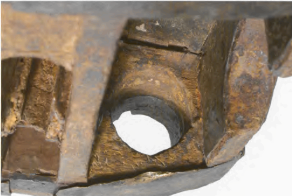
103 Beschädigungen im „Holz“ von Querträger 3 durch den Einsatz eines Gravierbeitels.
