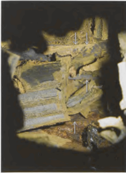
15 Hohlraum von Querträger 3 mit Holzresten und Eisenreif 3.1.
