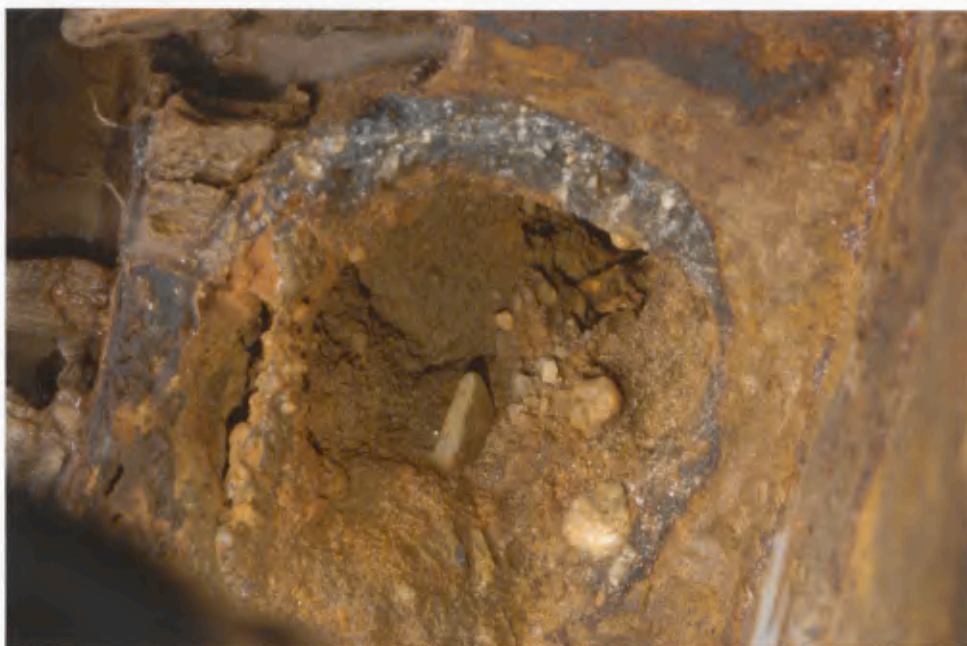
97 Spannbuchse B, Korrosionsschicht im Inneren.
