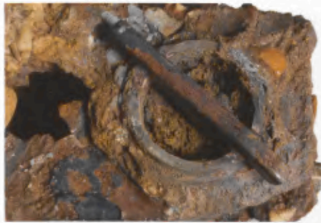
73 Querträger 4. Nach Entfernung der Hölzer wieder eingefügte Teile im Bereich der Beschädigung von Beschlagplatte 4.2.
