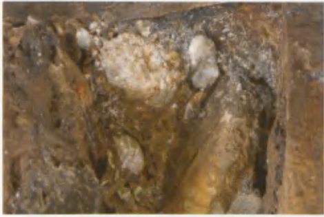
102 Korrosion mit Kieseinschlüssen im Bereich der Unterseite von Spannbuchse C.
