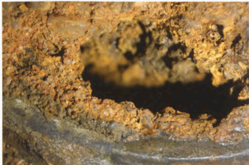
89 Spannbuchse A, Öffnung in der Korrosionsschicht und darunter befindlicher Hohlraum.
