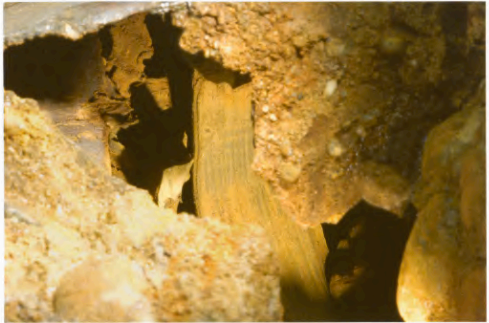
4 Hohlräume: Holzreste von Block 9 im Bereich von Querträger 4.
