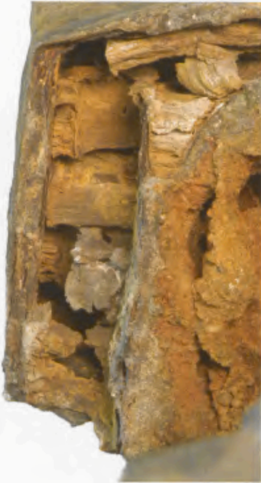
64 Reste der Zapfverbindung von Seitenständer 6 im oberen Querträger 4.
