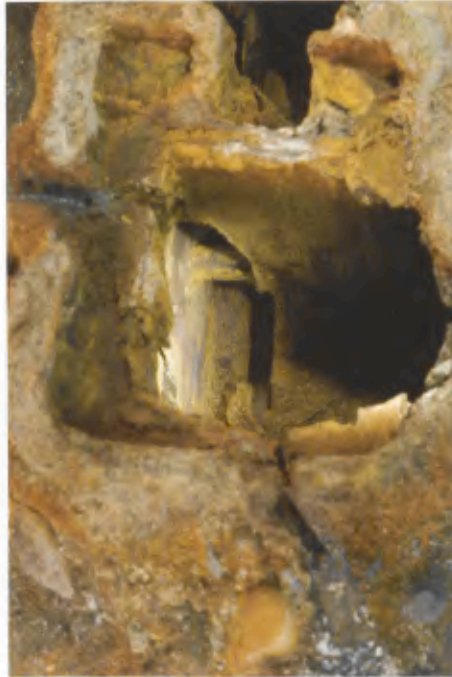
13 Vierkantnagel im Hohlraum von Mittelständer 8 in der Korrosionsschicht zwischen Pfeife 1 (unterer Hohlraum) und Schieber 2 (oberer Hohlraum).
