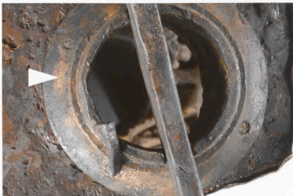
59 Spannbuchse D, Verformung der oberen Rundleiste (Pfeil).
