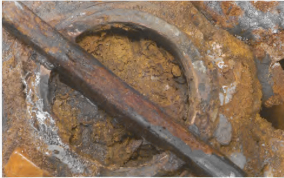
90 Spannbuchse A, Korrosionsschicht im Inneren.
