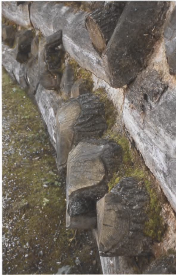
10 Die archäologisch belegte Lehm-/Tonverschmierung der Fassaden bildete im Nachbau ein großes Problem. Naturbelassener, mit organischem Material gemagerter Lehm hält starken Regengüssen nicht stand. Die Burgmauer ist mit einer 80°-Innenneigung völlig ungeschützt. Der Lehm wäscht aus, große Brocken fallen heraus. Der später gewählte moderne Lehmbaustoff wurde per Hand in einem dreilagigen Einbau eingebracht. Die Wallmauer „mit Patina“ nach vier Jahren.
