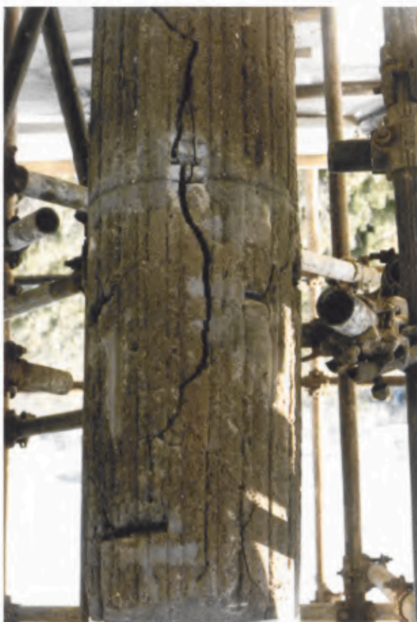
19 Pompeji, Mausoleum der Istacidier, obere Ordnung, durchgehende vertikale Risse in einer Säule.
