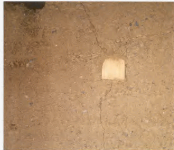
12 Risse ausgehend von einem in die Laibung eingestampften trockenen Holzkeil.
