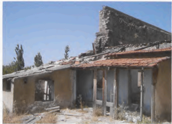
19 Das verfallene Wächterhaus südlich des Rundturms vor Beginn der Abbruchmaßnahmen (2006).
