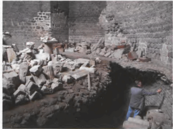
18 Einsturzgefährdete Gewölbepartien im Inneren des südlichen Rundturms vor Beginn der Maßnahmen (2005).
