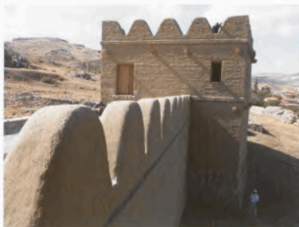
16 Das Ziegelmauerwerk paust sich durch den dünn aufgetragenen Verputz durch.
