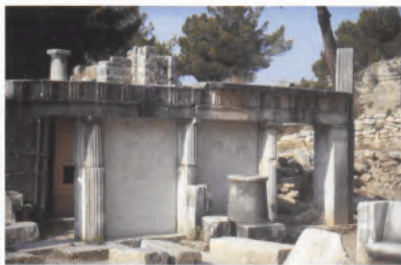
9 Proskenion. Westende mit moderner Ausmauerung. Architrave gebrochen und verschoben.
